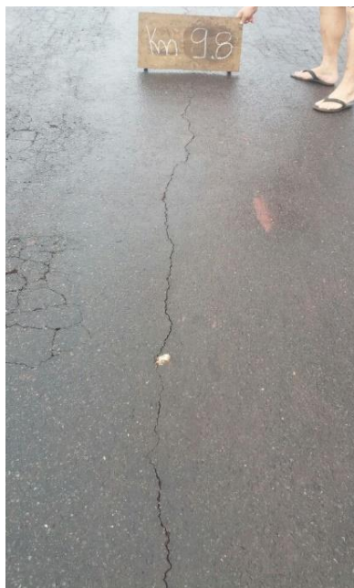
Figura 6 - Trinca isolada longitudinal
