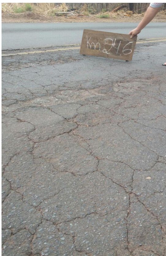
Figura 8 - Trinca couro de jacaré com erosão
