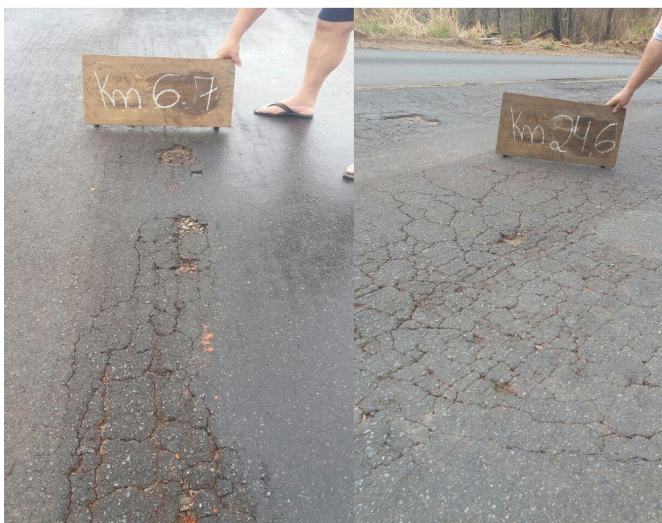
Figura 7 - Trinca couro de jacaré
