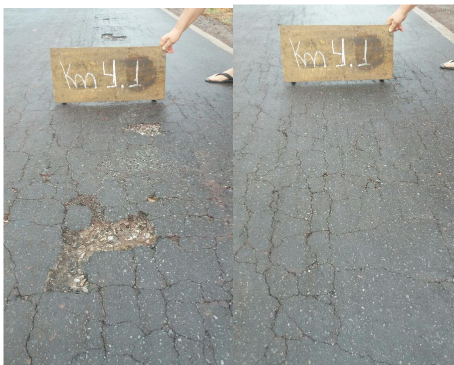
Figura 09 - Trincas de bloco
